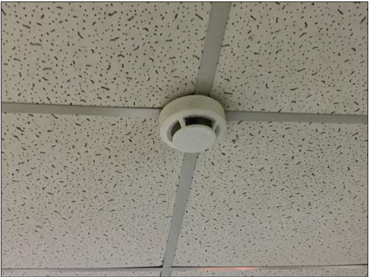
Фото 5. Дымовой пожарный извещатель Объекта экспертизы.
