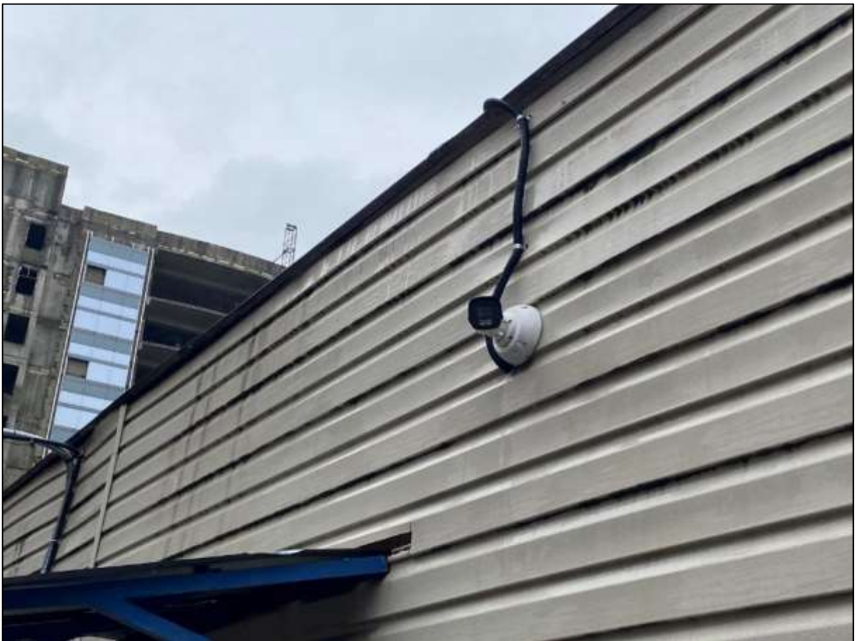
Фото 7. Камера системы охранного видеонаблюдения.
