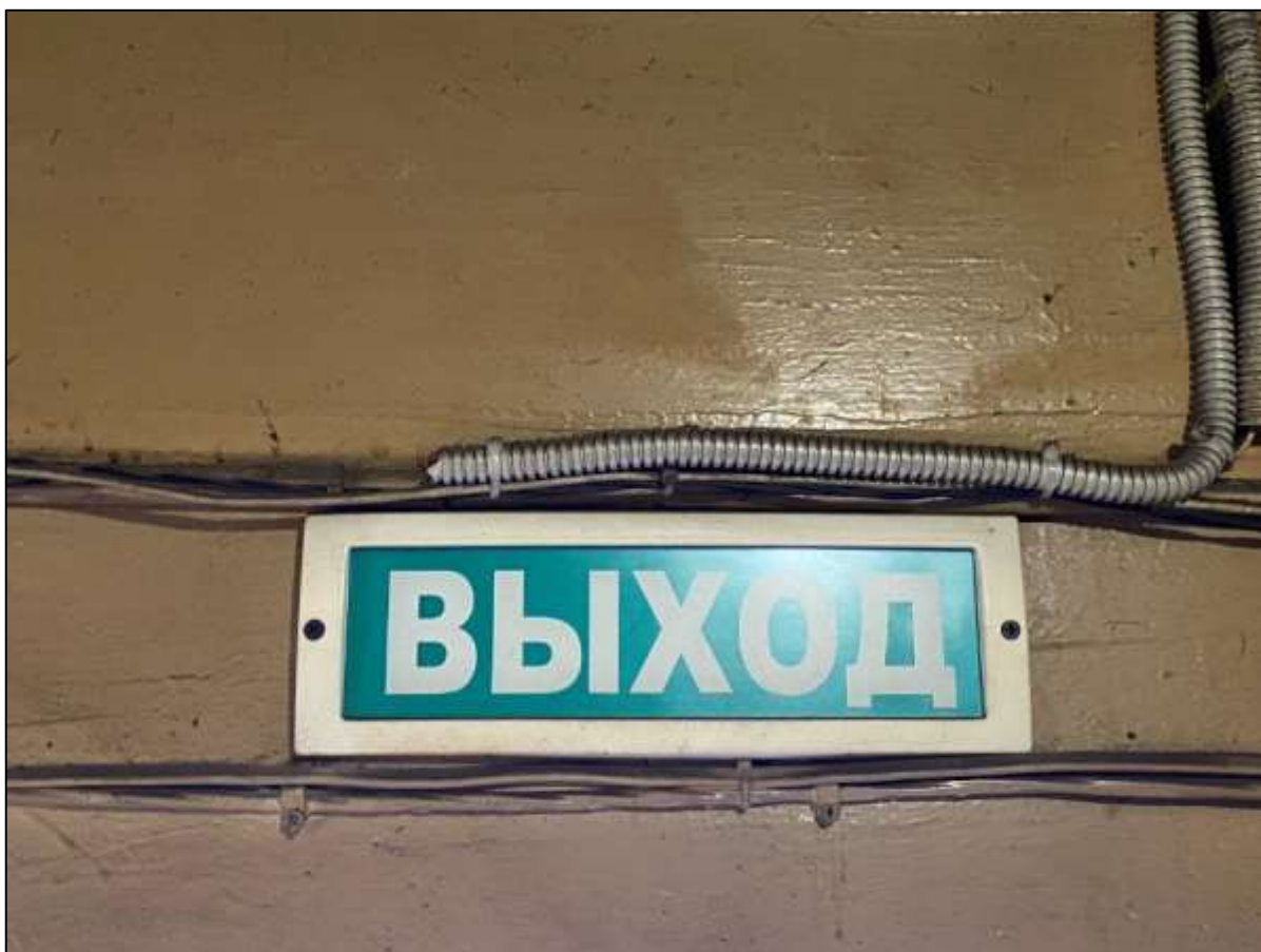
Фото 9. Световая табличка «ВЫХОД» системы оповещения и управления эвакуацией.
