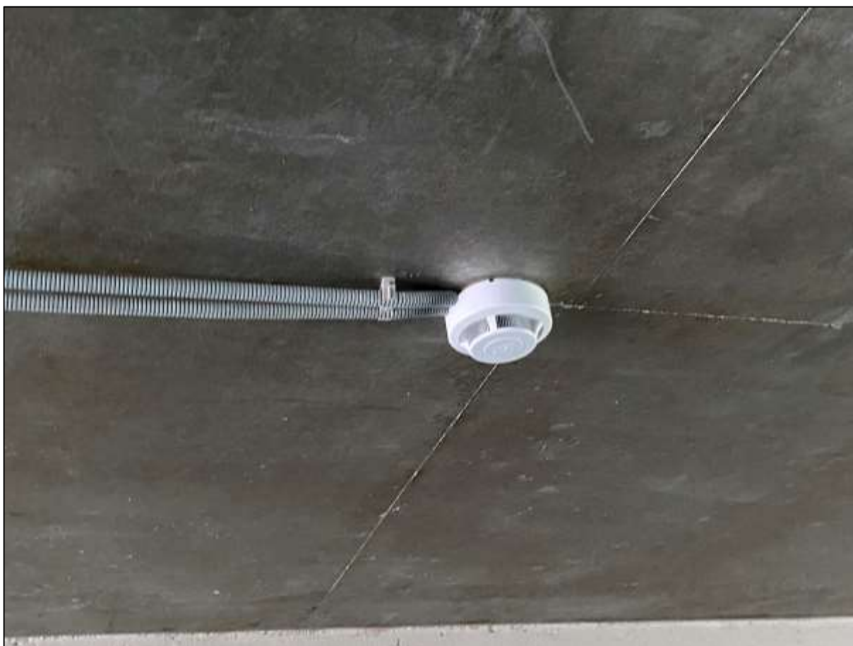
Фото 5. Дымовой пожарный извещатель Объекта экспертизы.
